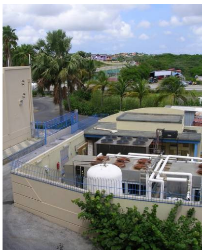
Foto 4.1 Eigen opwekking van elektriciteit bij hotel
